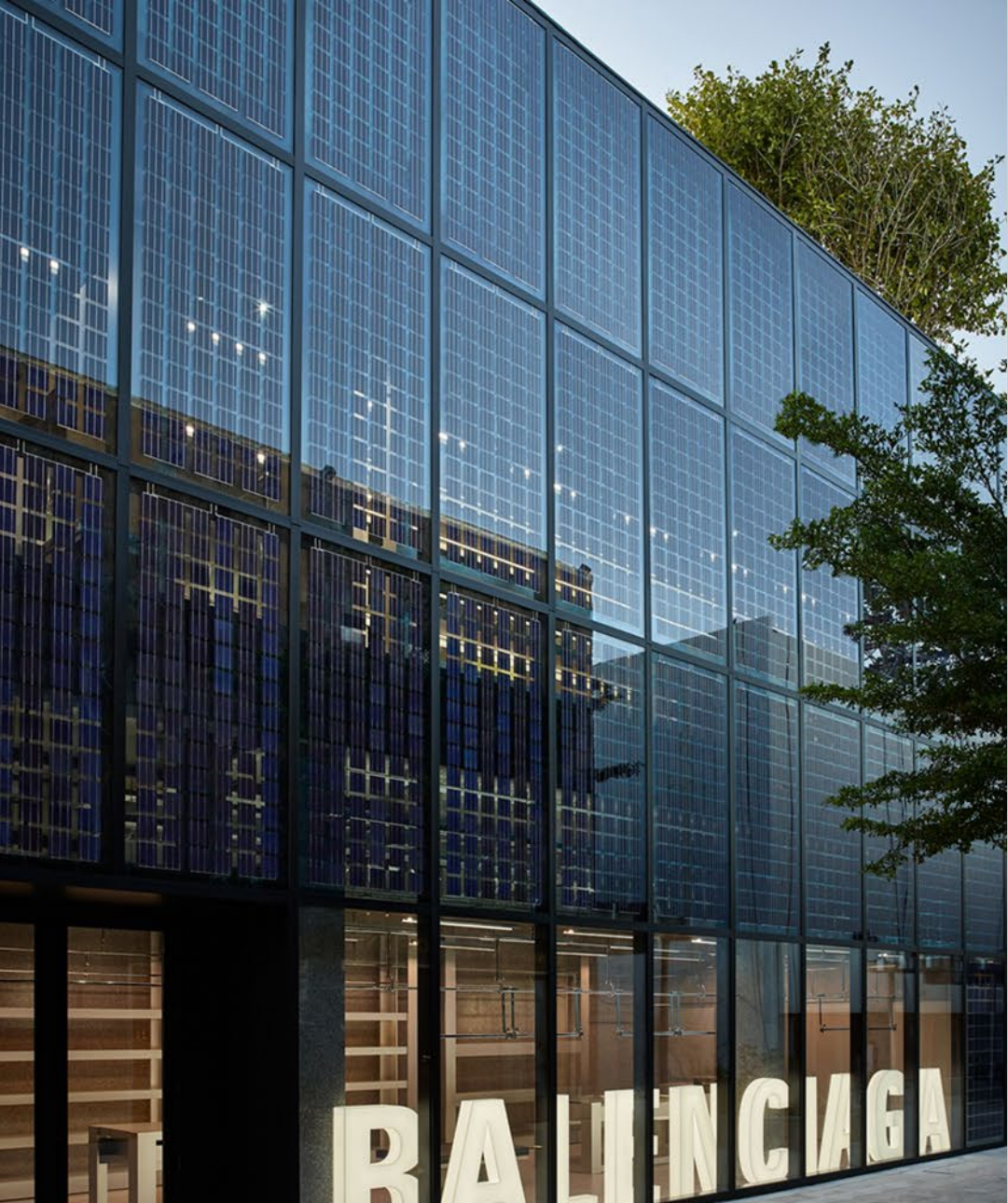
Muro cortina en silicio policristalino con vidrio trasero azul. Balenciaga Store. Miami, USA.
